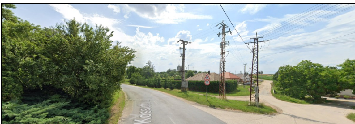
Transzformátor állomás a Kossuth Lajos utcában a módosítással érintett 106 hrsz-ú telektömbnél
