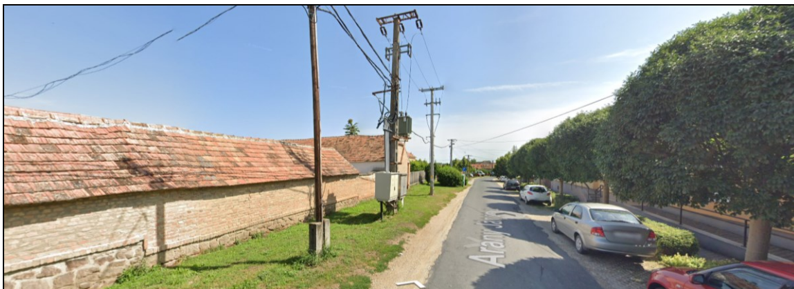
Transzformátor állomás az Arany János utcában a módosítással érintett, a 12/1-4 hrsz-ú telektömbnél
